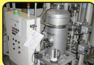
プラスチック洗浄水：3m 3 /hr モノ MAX ユニット 300A
