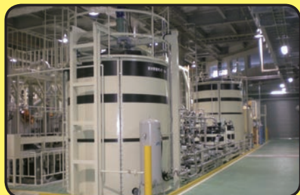
微細プラスチック洗浄水：12m 3 /hr モノ MAX ユニット 500A
